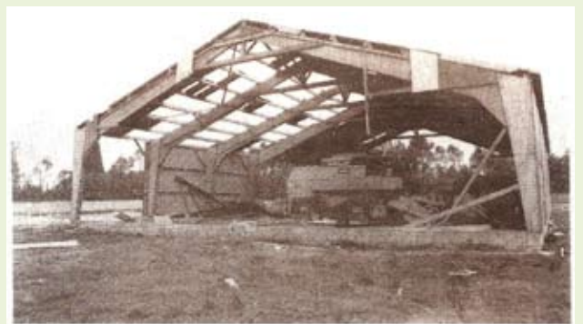
Nuit du 15 octobre 1987 : bâtiment agricole très endommagé par l'ouragan
